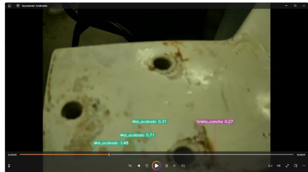
Figura 10.- Ejemplo de la detección de defectos en un perfil de un álabo con el modelo empleado.
