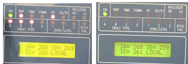
Figura 9.- Panel frontal del relevador
