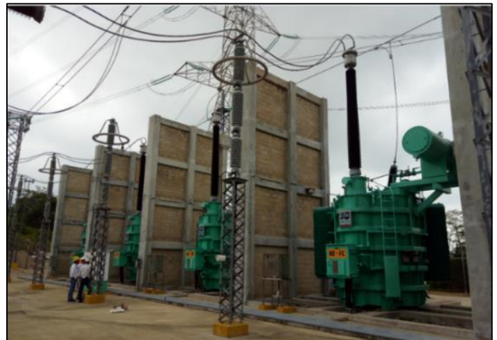
Figura 2. Fotografía de un banco trifásico típico de reactores en derivación tipo columna de 75 MVar (25 MVar/fase). Se observan reactores de fase y la reserva.
